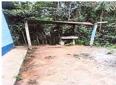
Foto 2: Lavadero en mal estado
