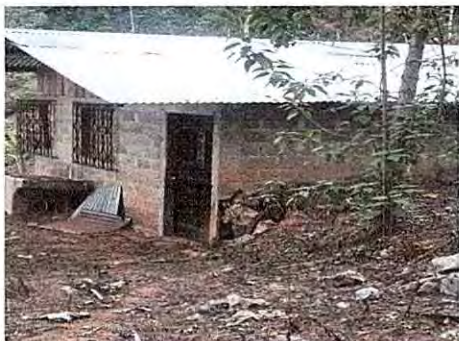
Foto1: Cocina en mal estado
