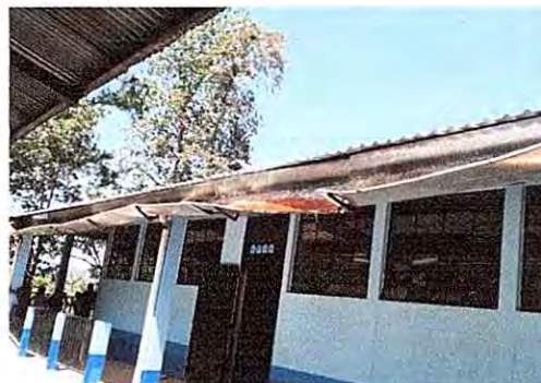
Foto 4: Canales en mal estado
